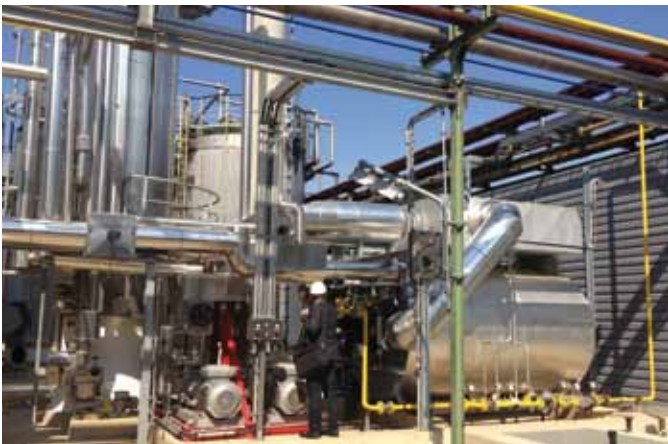
Calentamiento de reactores (Alemania) Reaktorbeheizung (Deutschland)
