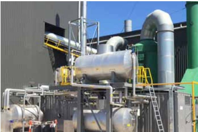
Instalación en contenedor (Australia) Containeranlage (Australien)
