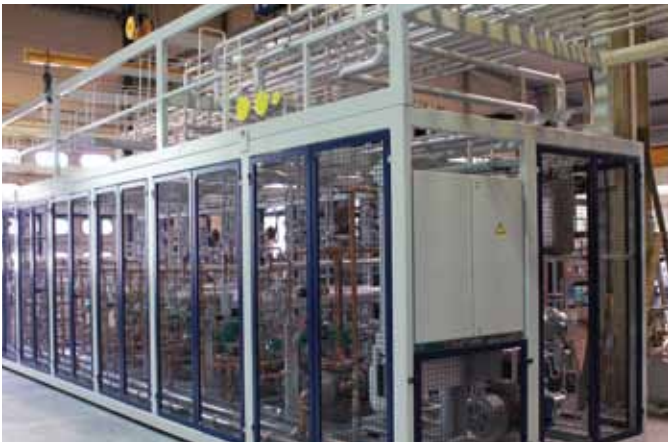
Calentamiento de prensas hidráulicas (Germany) Pressenbeheizung (Deutschland)
