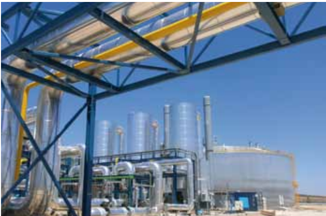
Planta termosolar (España) Thermisches Solarkraftwerk (Spanien)
